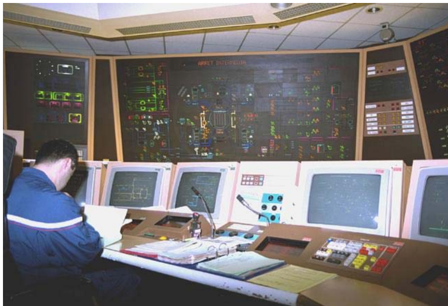
Salle de commande des tranches N4.
